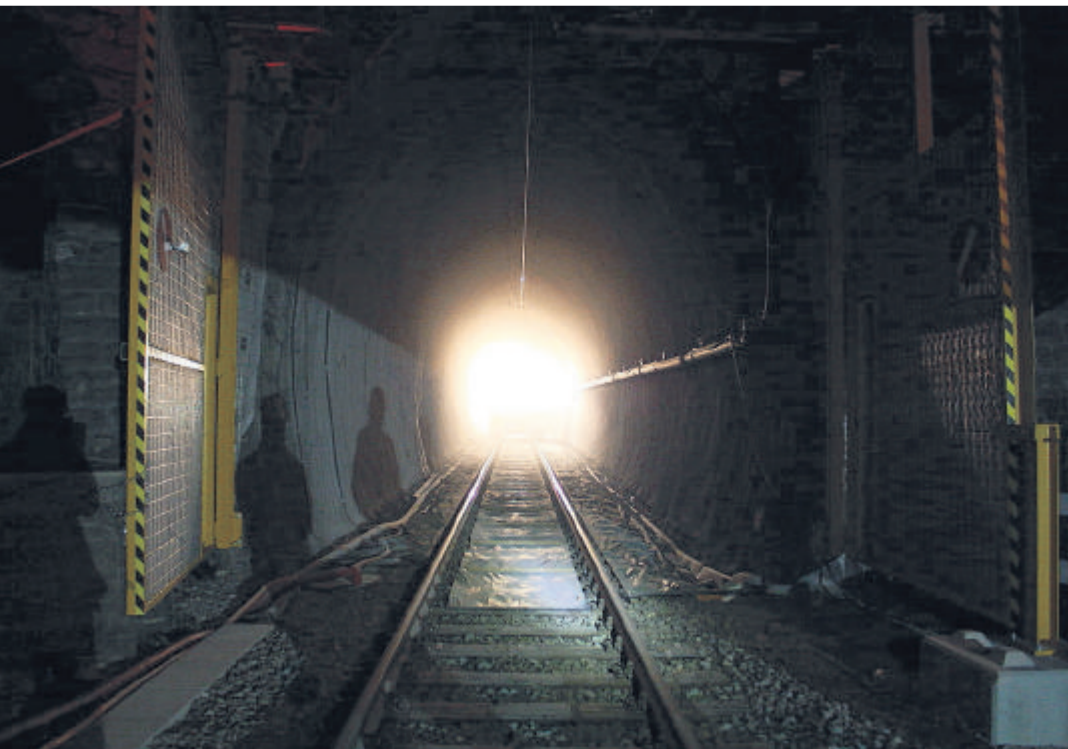
Eingangsportale Lichtensteig: Im Normalfall sind die Lärmschutzzore (links und rechts) geschlossen.
