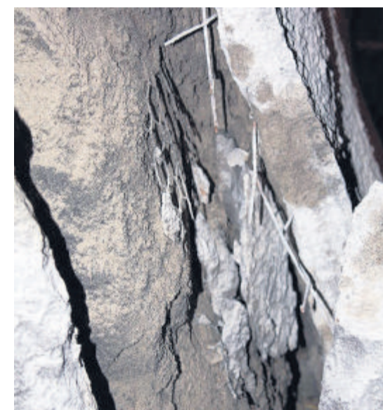
Durch Wasser zerstörte Betonschalung.
