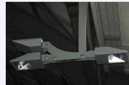
Die neue Beleuchtung der Bahnhofshalle St. Gallen (Sanierung Architektenkollektiv, Winterthur): Indirektes Licht hebt die historische Hallenstruktur sanft hervor. © Foto R. C. Dürr/EBP
