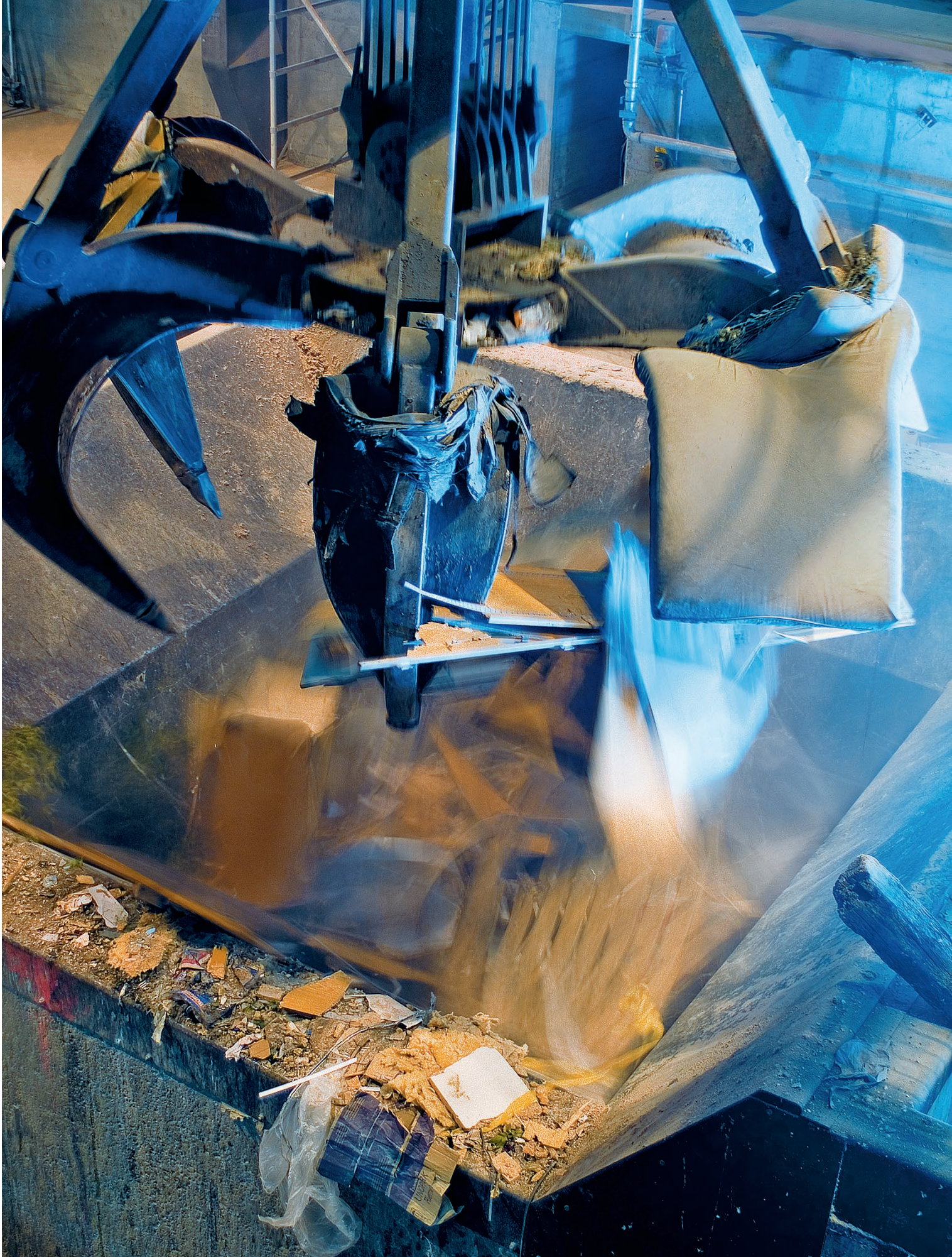
Ein grosser Greifer mit einem Fassungsvermögen von 6,3 m 3 stellt sicher, dass die beiden Verbrennungsöfen im Kehrichtheizkraftwerk Hagenholz rund um die Uhr zuverlässig mit neuem Brennstoff, d. h. Abfall, beschickt werden.
